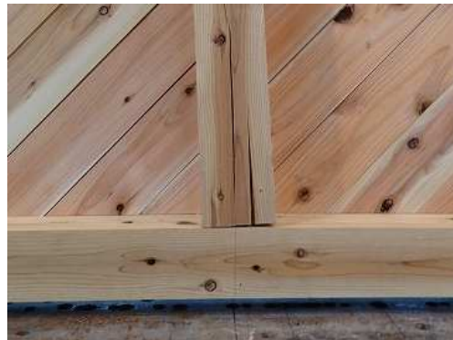
写真 2.2.2 中柱の割れ (1/15rad 時)
