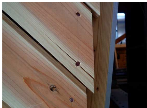
写真 2.2.6 板材の割れ (1/15rad 時)
